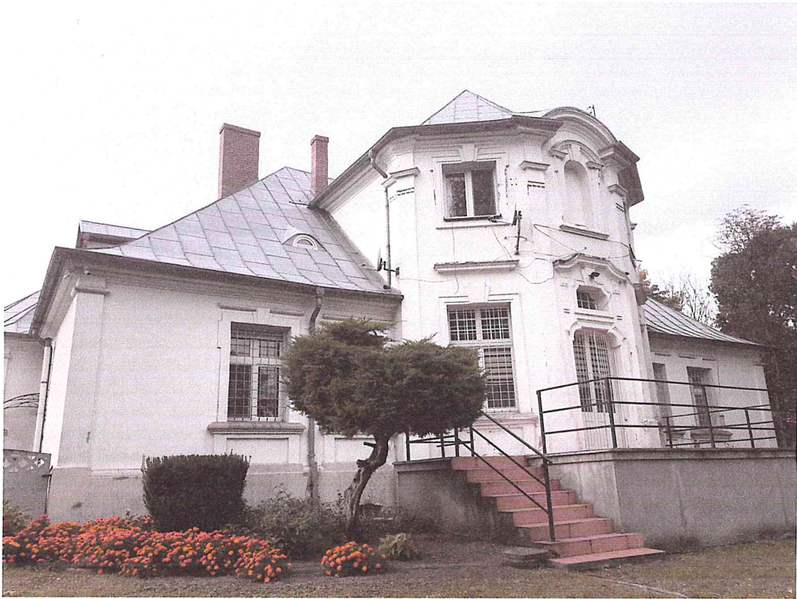
Fot. 3 - Elewacja ogrodowa - wschodnia. Widoczny taras oraz okna bez podziałów historycznych.
