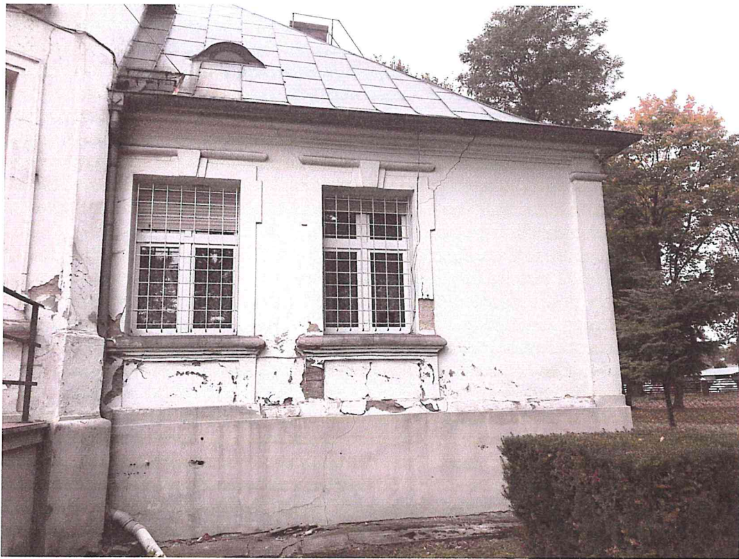
Fot. 7. Elewacja ogrodowa - część północno- wschodnia. Widoczne uszkodzenia nadproża - spękania, przechodzące do ściany fundamentowej. Układ odprowadzania wody wymagający usprawnienia.
