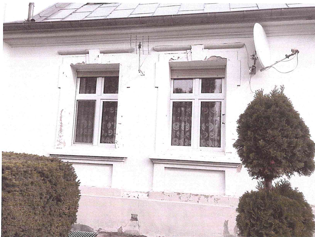
Fot. 13. Elewacja frontowa - zniszczenia obramień okien, brak pól dekoracyjnych z tynku, wtórna antena.
