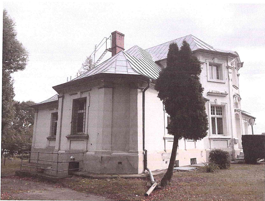
Fot. 10. Narożnik północno- zachodni. Widoczne elementy niesprawnego systemu odprowadzania wody.
