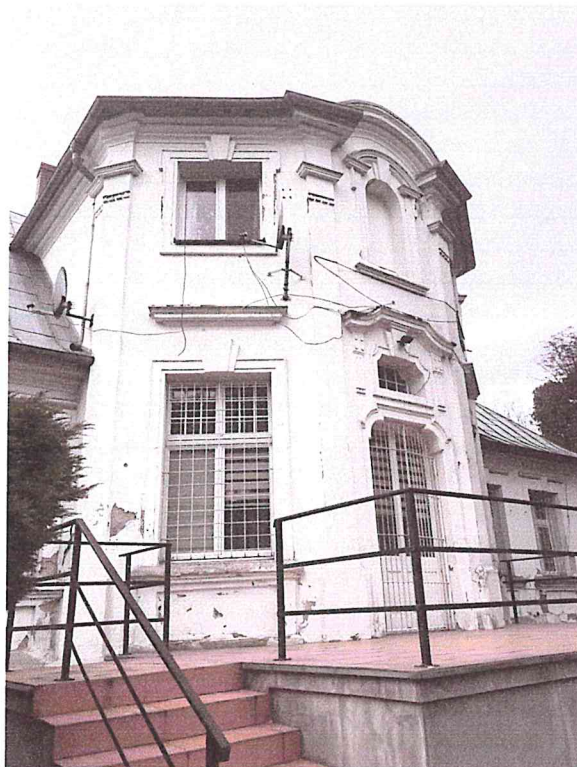
Fot. 4. Elewacja ogrodowa- wschodnia. Widoczne uszkodzenia tynku, wtórne instalacje elektryczne i antenowe do uporządkowania. Taras z wtórną balustradą stalową - do przebudowy wg osobnego opracowania..
