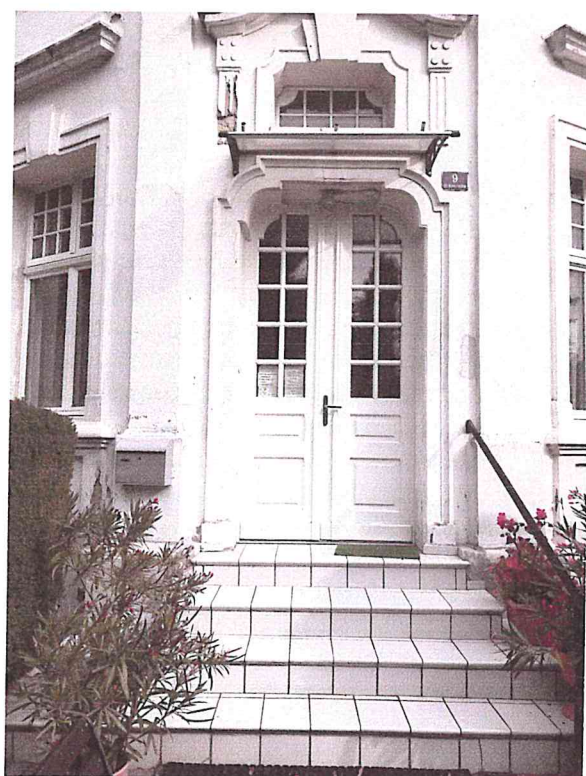
Fot. 11. Wejście główne. Płytki gresowe do wymiany na okładzinę kamienną. Daszek do demontażu.
