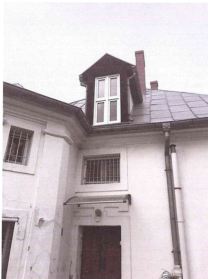
Fot. 12. Elewacja południowa. Daszek do demontażu, okna PCV do wymiany.
